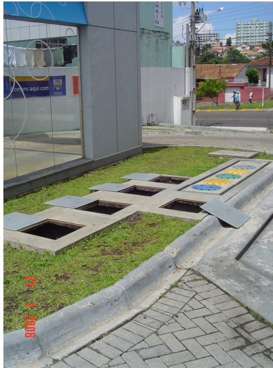
Figura n° 7 - Caixa separadora de água e óleo
