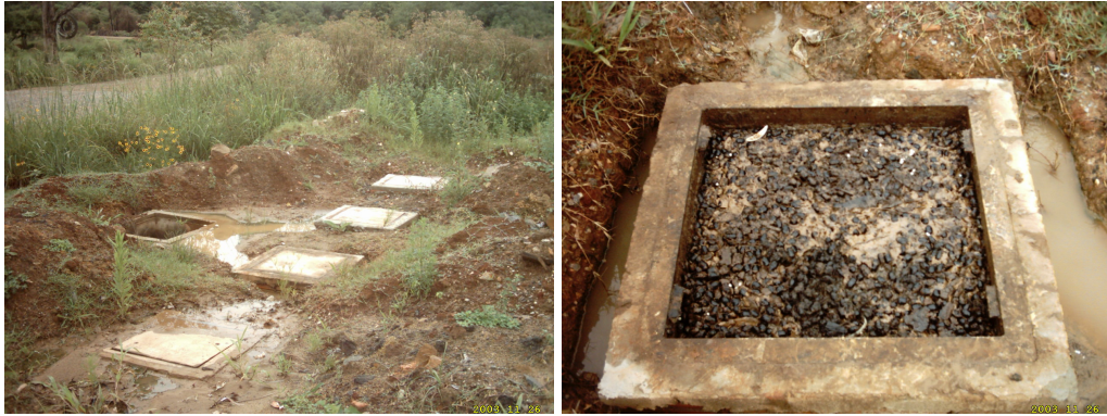
Figura nº 20 - Sistema inadequado de tratamento de efluentes
